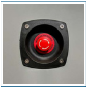
Parada de emergencia externa
