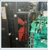
Refrigeración por agua
