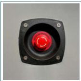
Parada de emergencia externa
